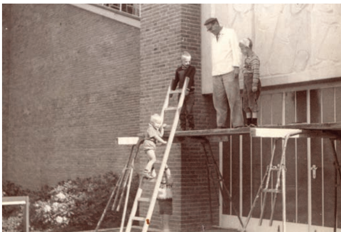
Eingangportal St. Markus, ev., Stade Hahle. Das Ansetzen des Sandsteinreliefs „Die Lauschenden“
